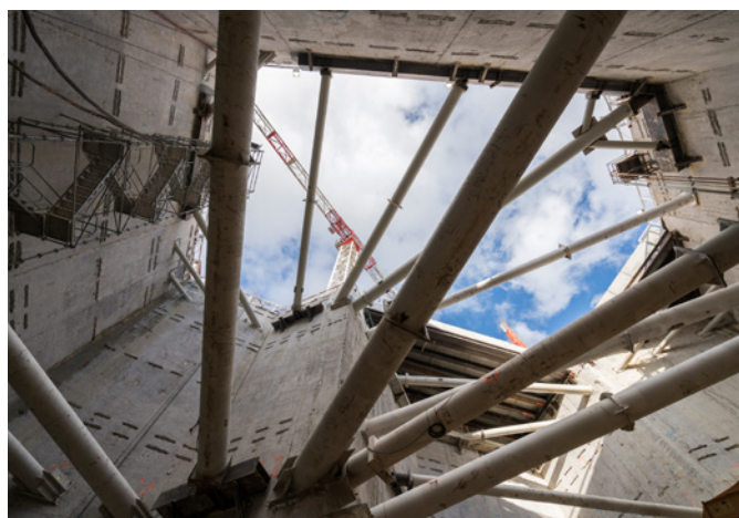
Tunnels en souterrain du prolongement de la ligne 4 du métro, de Montrouge à Bagneux - © Alex Soria
